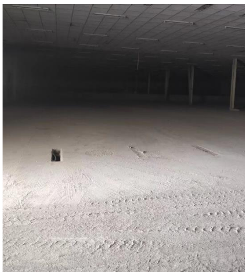
图 2 车间内部照片
