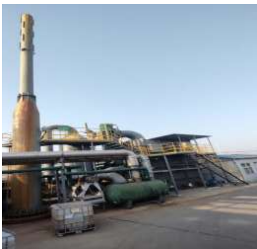
厂区 RT0 处理装置
